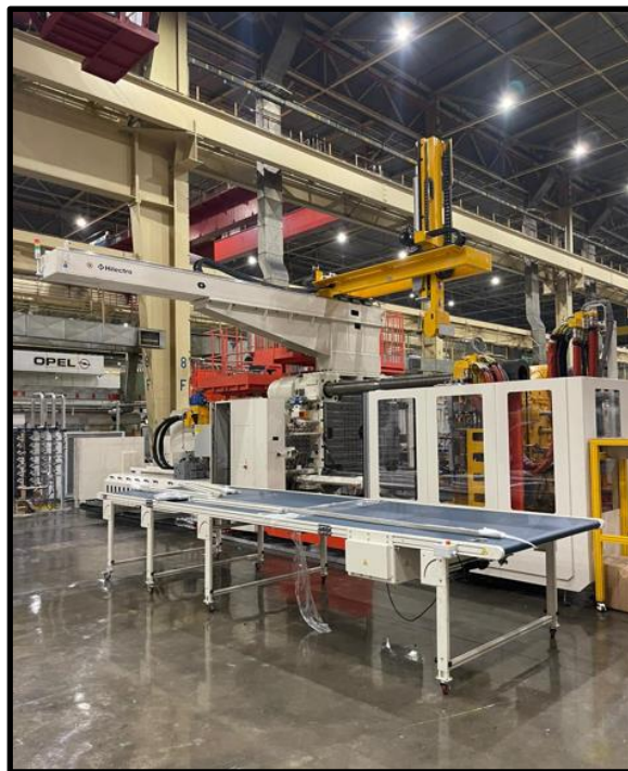
Primera máquina de inyección de plásticos instalada
